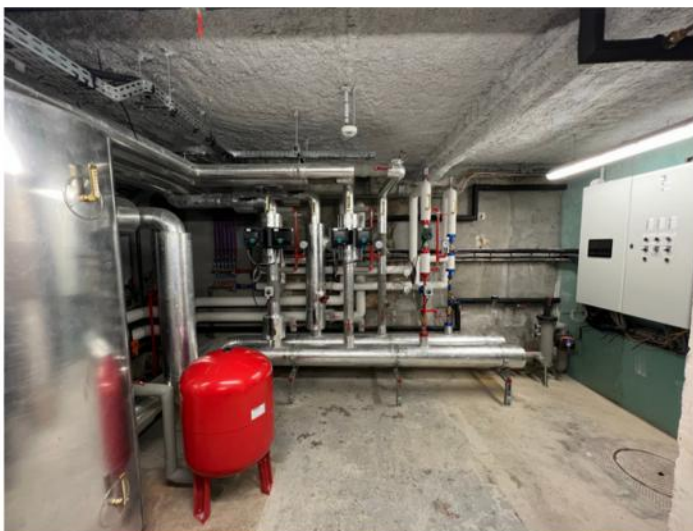
Climatisation et chauffage réversible
